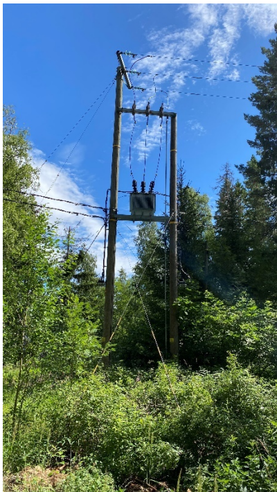
Suunnittelualueella sijaitseva sähkölinja.
